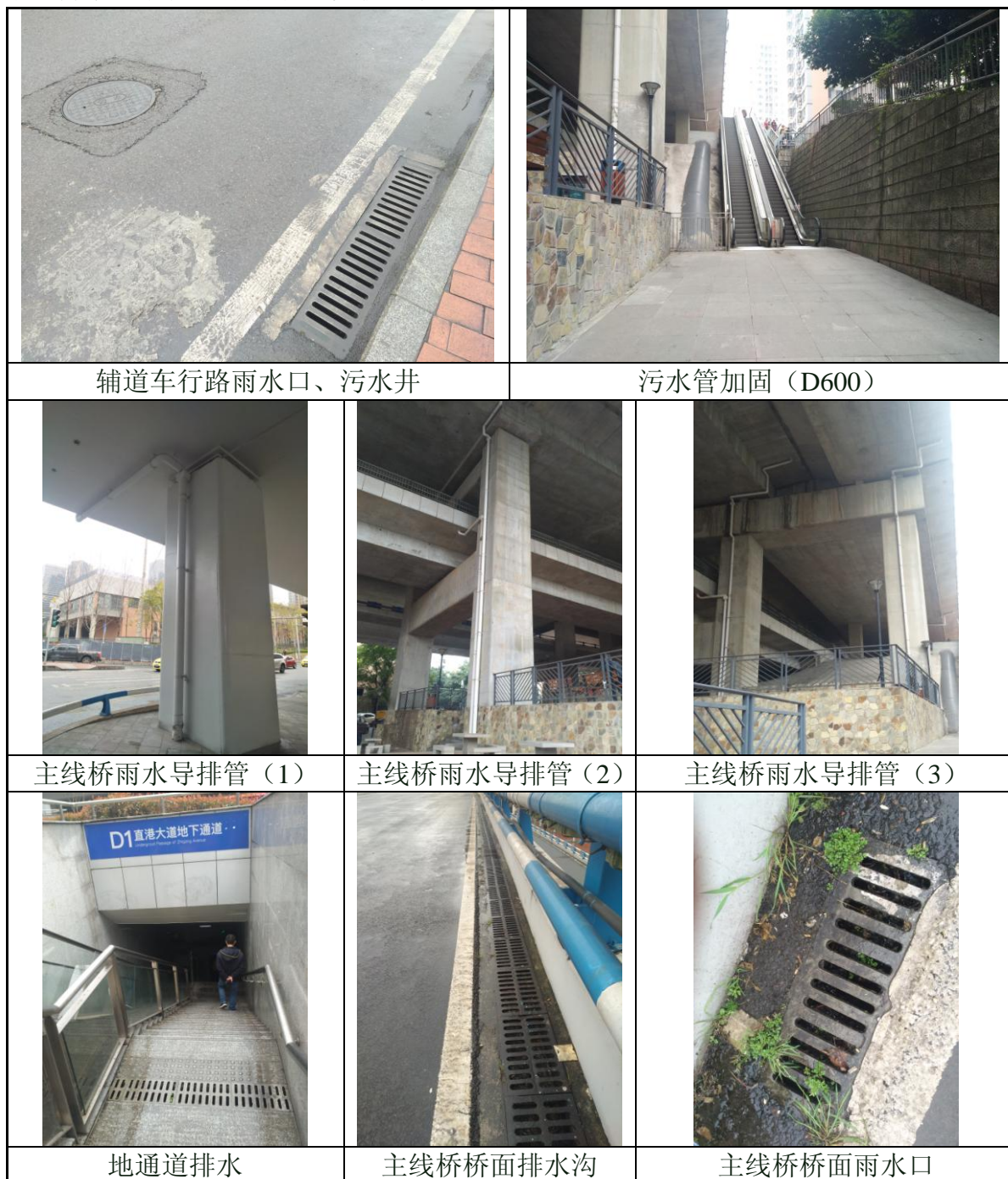
图 5.3 排水设施实景
